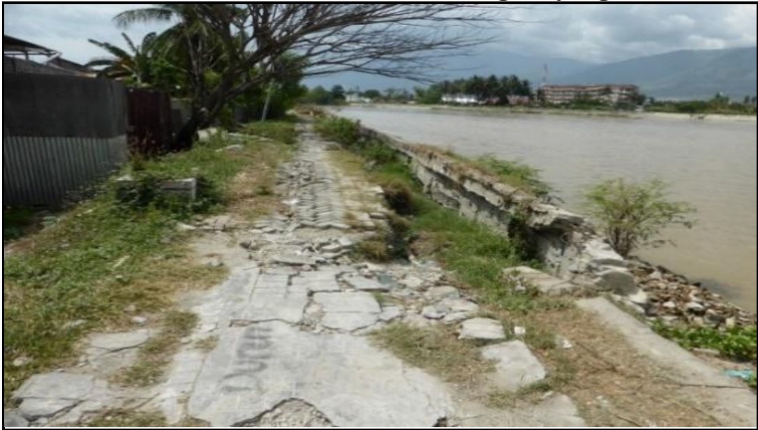
Gambar II.11 Foto Kondisi Jalan Lingkar yang Rusak
