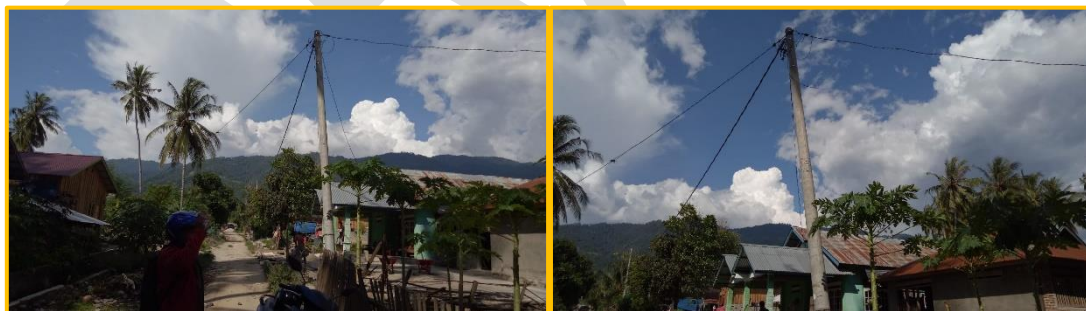
Gambar 22 Foto tiang Listrik terdekat dari lokasi Huntap Lambara Sumber: Survei Lapangan Tim Fasilitator, Tahun 2020
