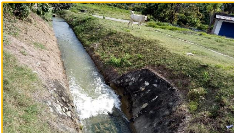
Gambar 25 Sistem drainase di sekitar Huntap Lambara Sumber: Survei Lapangan Tim Fasilitator, Tahun 2020.
